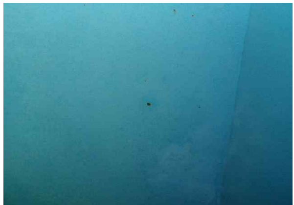
손상내용 1지 상부슬래브 녹 손상원인 피복부족
