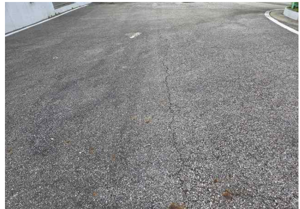
손상내용 장내포장 아스콘균열 손상원인 공용열화
