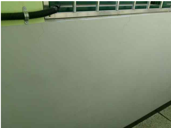
손상내용 전기실 벽체 망상균열 손상원인 건조수축
