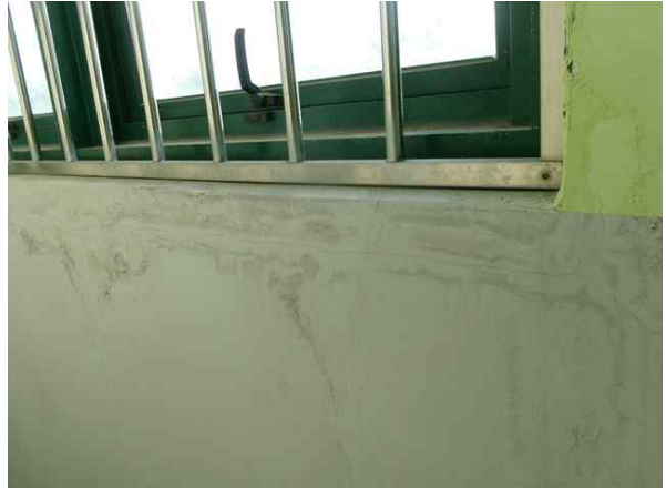
손상내용 전기실 벽체 균열 손상원인 건조수축
