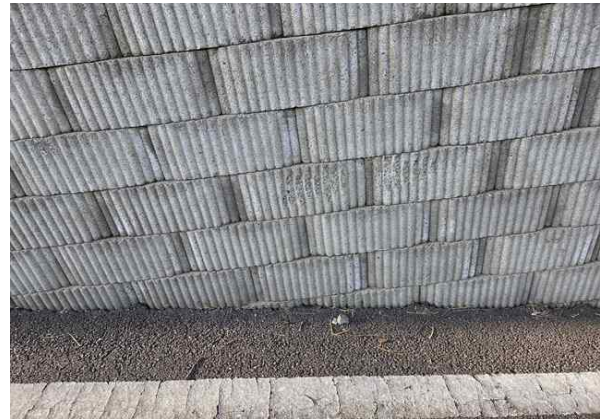
손상내용 보강토옹벽 블록파손 손상원인 외부충격
