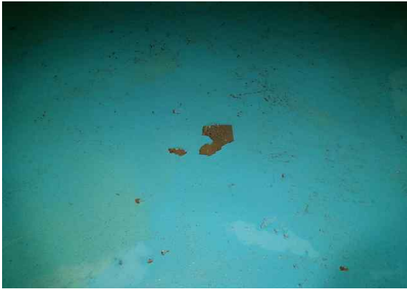
손상내용 1지 바닥슬래브 도장박리 손상원인 공용열화
