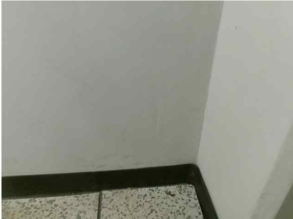
손상내용 전기실 벽체 균열 손상원인 건조수축
