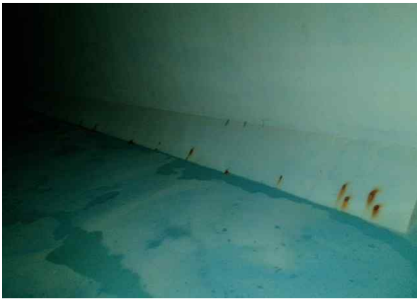
손상내용 1지 벽체 녹물 손상원인 피복부족
