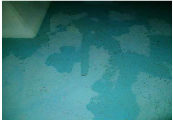
손상내용 1지 바닥슬래브 표면박리 손상원인 공용열화
