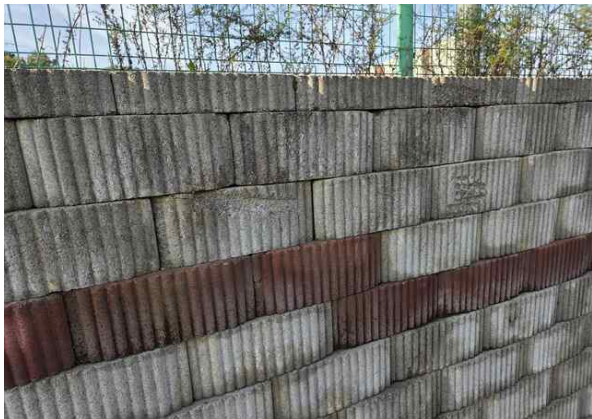
손상내용 보강토옹벽 블록파손 손상원인 외부충격
