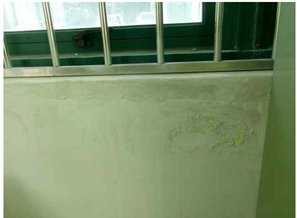
손상내용 전기실 벽체 도장박리 손상원인 공용열화
