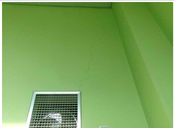
손상내용 전기실 벽체 망상균열 손상원인 건조수축
