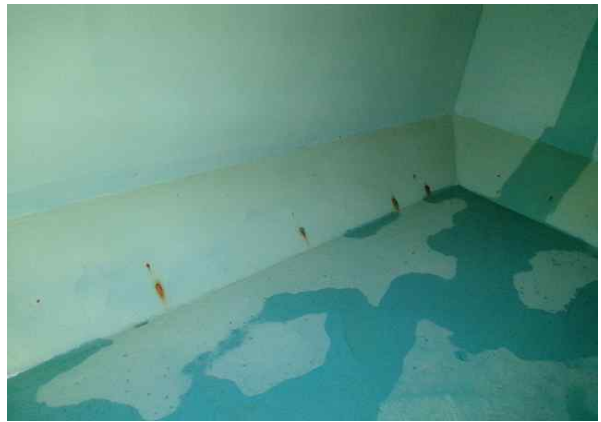
손상내용 1지 벽체 녹물 손상원인 피복부족
