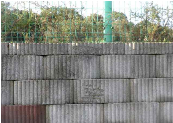
손상내용 보강토옹벽 블록파손 손상원인 외부충격
